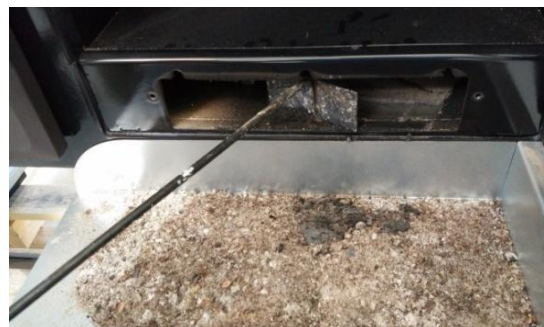
Figura n°22 - Accès pour le nettoyage de la sortie de fumée
